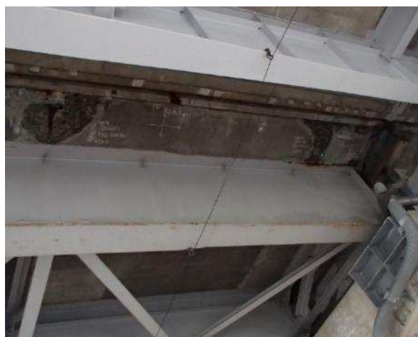
＜矢作高架橋の損傷状況＞
