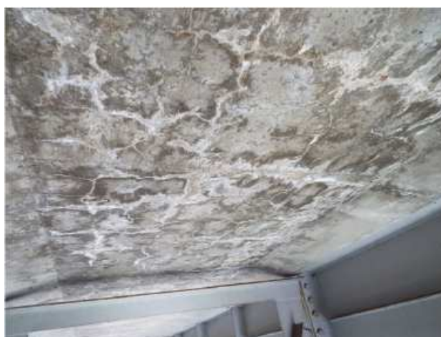
＜中村川橋の損傷状況＞
